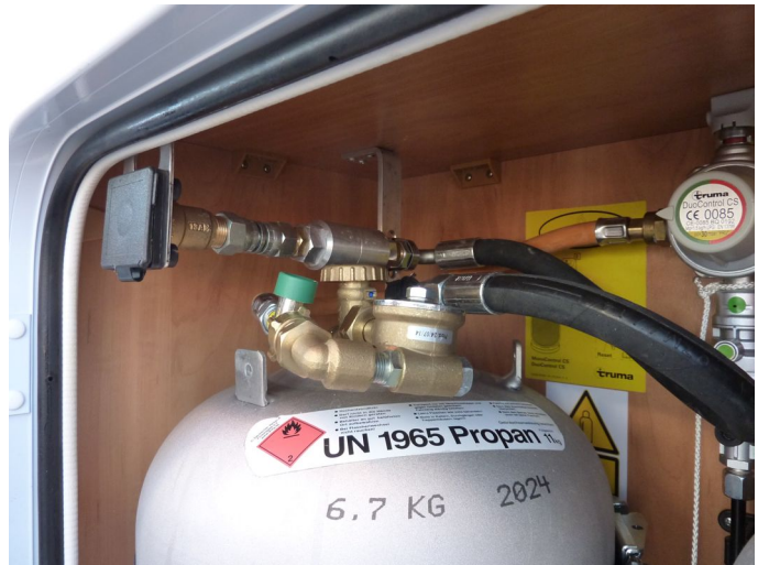
Installation de bouteille fixe Photo 3
